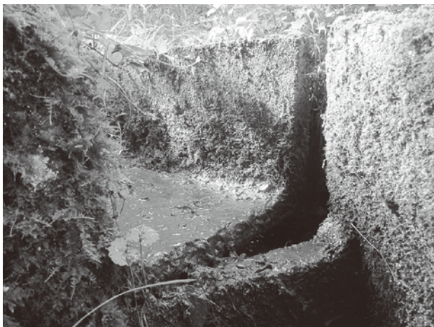
老朽化した水路
