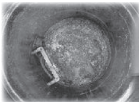
▲下水道管に油の塊が詰まっている様子
