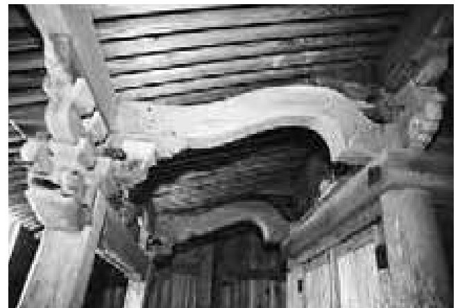
図496 荒霊神社本殿庇
