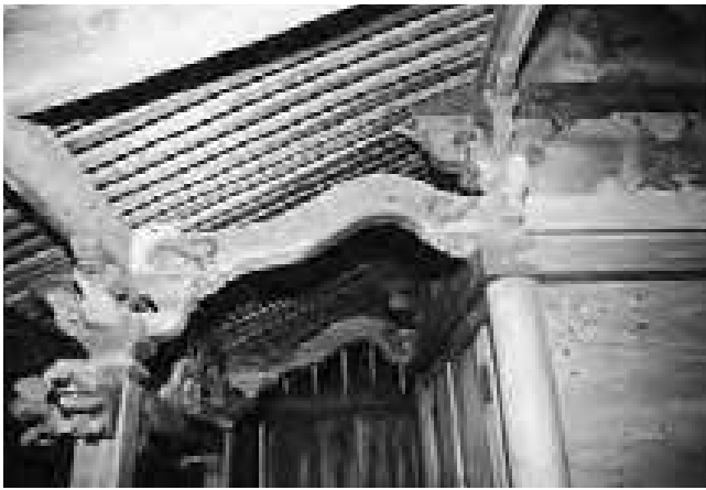
図616 荒霊神社本殿庇
