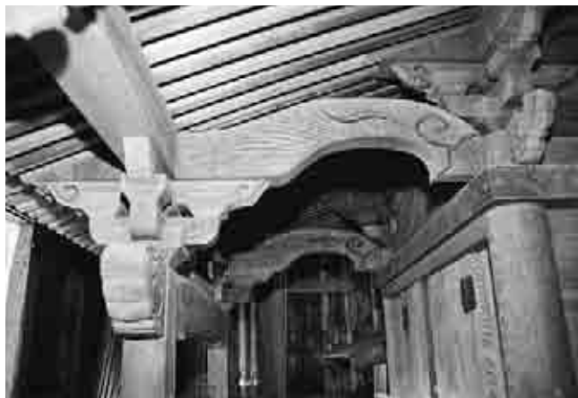
図499 荒霊神社本殿庇
