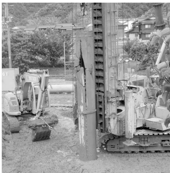
基礎ぐいが破損とは…
