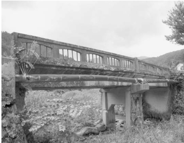
老朽化が進む橋梁
