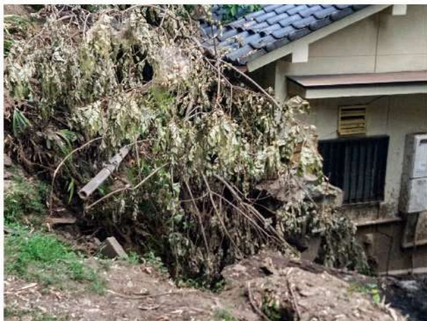
村岡区の土砂崩れによる住宅被害
