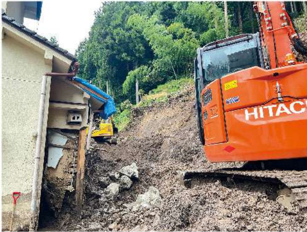
甚大な被害を受けた住宅!
