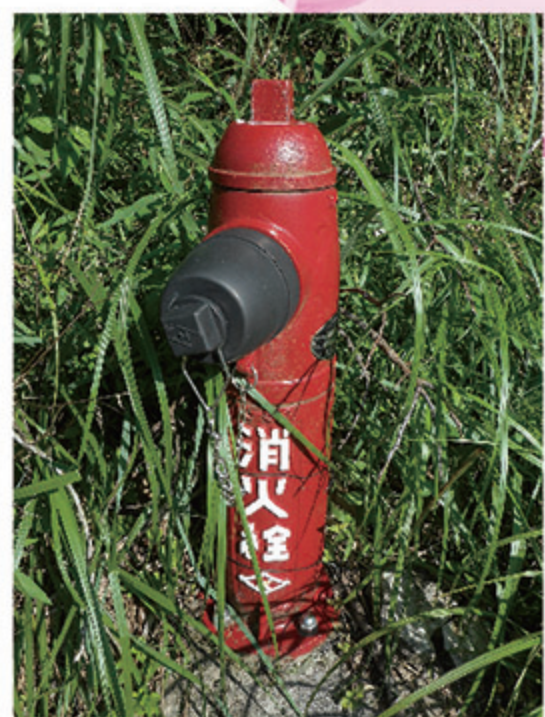
この消火栓水を出せる？
