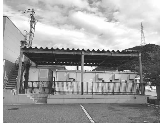
本庁非常用電源
